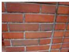
目地劣化タイル
