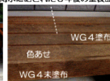
雨水に晒された3年後の塗装面
