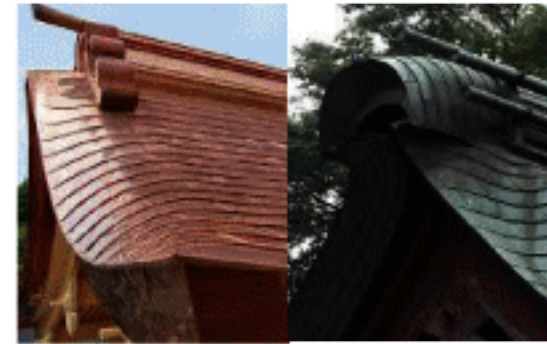
炭酸ガスによる銅板屋根の変色抑制を
